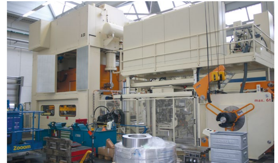
Meilenstein: Die neue 800-Tonnen-Transferpresse – hier noch im Aufbau – ist die bis heute größte Fertigungsmaschine des Unternehmens
